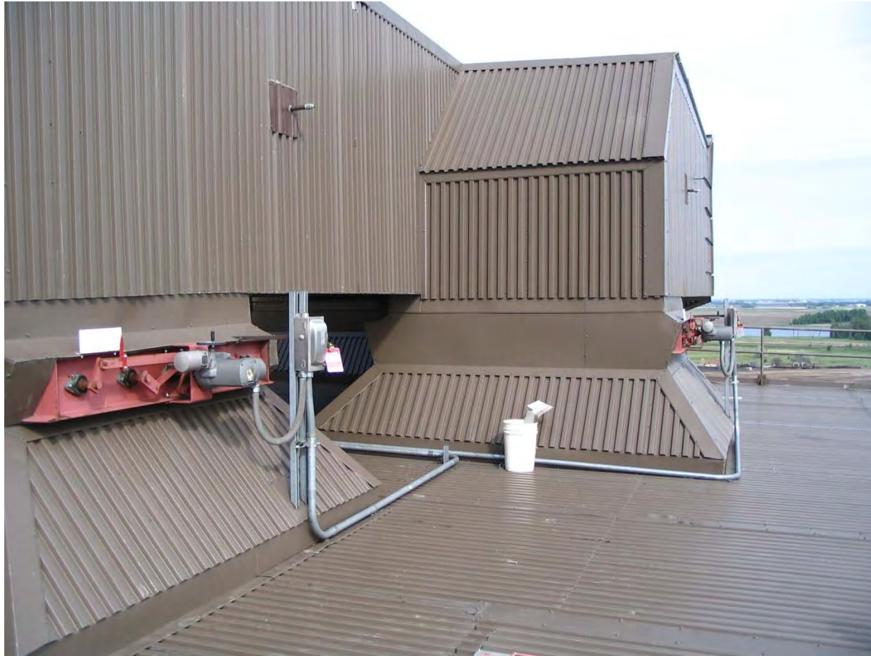
Outlet Plenum Louvre Dampers
